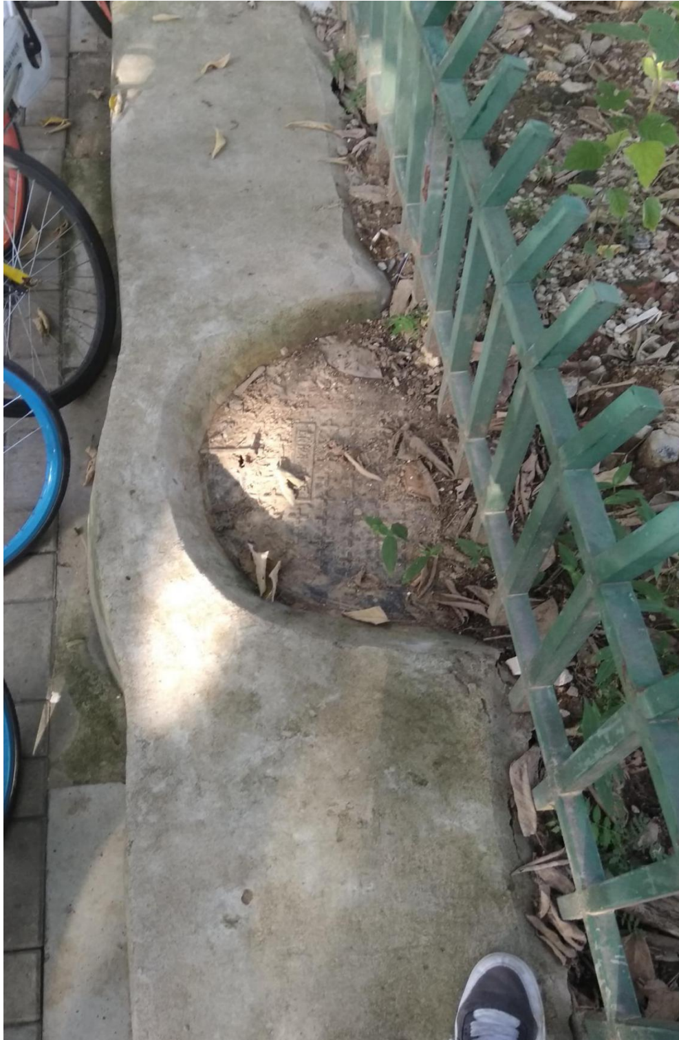
附件 14. 雨水总排口
